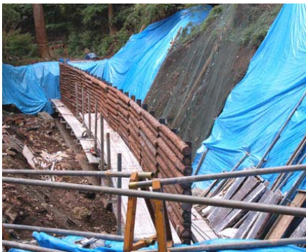
①外壁を造るにあたり、先ず間伐材で型枠を施工します。
