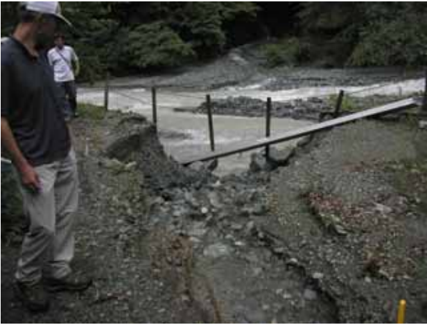
広場の一部が崩壊、大きな沢になってしまった。
